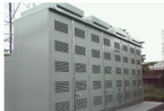
組み合わせにより、数千キロワット時を貯められるNAS電池
